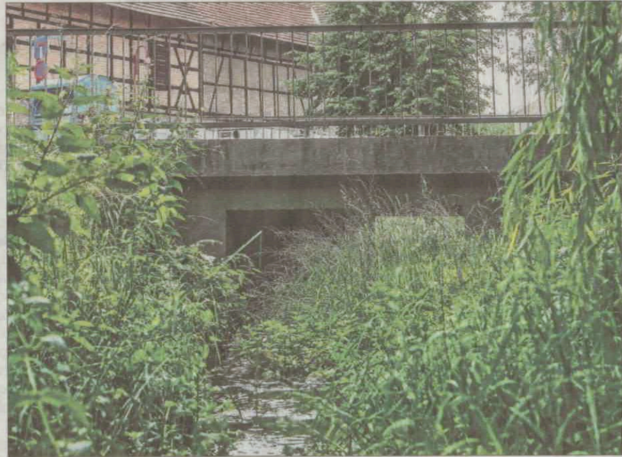
Viel zu klein ist der Durchlass der Trolle-Brücke in Büßleben. Die Brücke soll aber nicht einfach abgerissen, sondern umgebaut oder ersetzt werden. Foto: Paul-Philipp Braun
