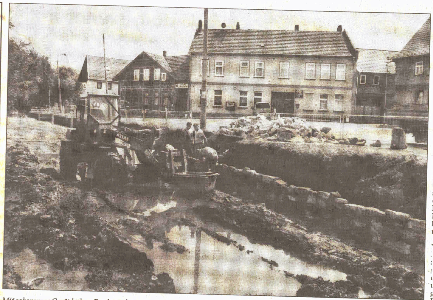
Mit schwerem Gerät haben Bauleute begonnen, den Lauf des Peterbaches in Bübleben zu sanieren. Sie ersetzen u.a. die Randbefestigung mit Bruchsteinen, ein neues Geländer wird aufgestellt und wie früher sollen am Ufer bald wieder Linden Schatten spenden. Fördermittel tragen einen Großteil der Baukosten von etwa 400 000 Mark.
