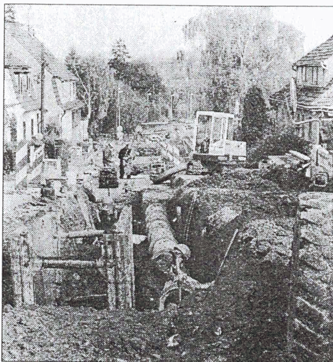
Bis Mitte Dezember wird die Kreisstraße durch Bübleben grundhaft ausgebaut mit Verlegung des Abwasserkanals. Bis dahin soll auch die Peterbach-Brücke fertig sein. TA-Foto: M. EIERT
