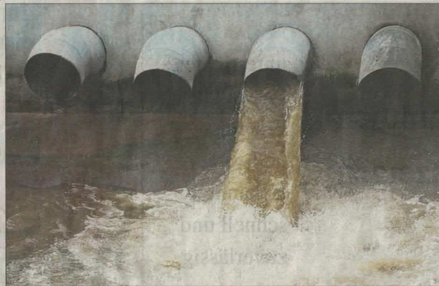
Für den Weg des Abwassers ins Klärwerk werden in Erfurt immer noch verschiedene Gebühren berechnet.
