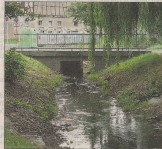
Die „Brücke Zur Trolle“ in Büßleben ist zu schmal.
