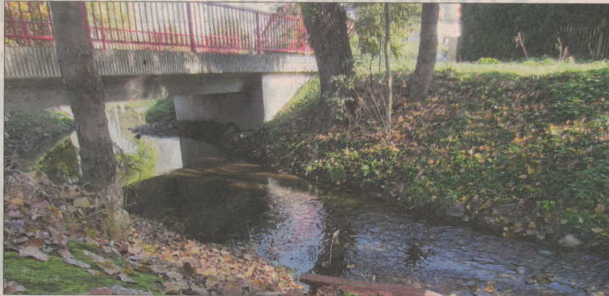
In Linderbach hat die Brücke am Ziegelgarten einen zu geringen Durchlauf und wird zum Stauwehr. Foto: Anja Derowski
